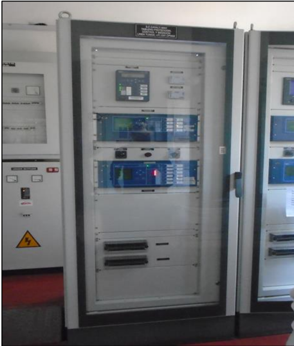
Fotografía 4. Tablero de Control
