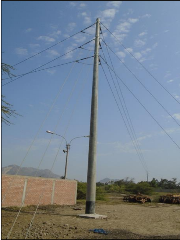
Fotografía 11. Vista de carretera hacia el poste 199
