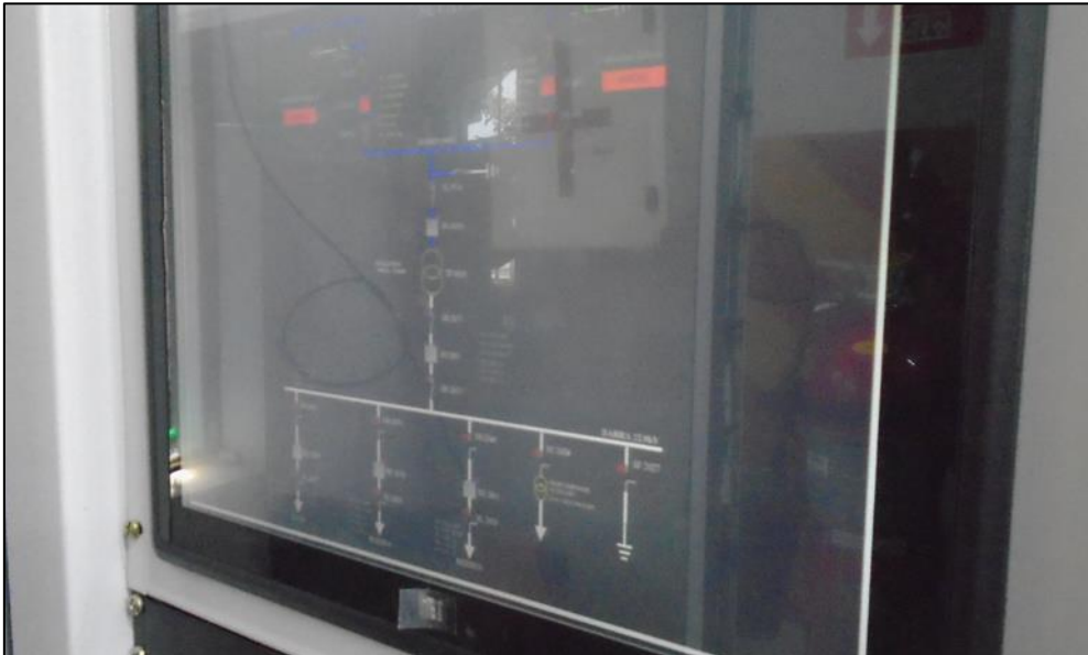
Fotografía 5. Tablero de Control
